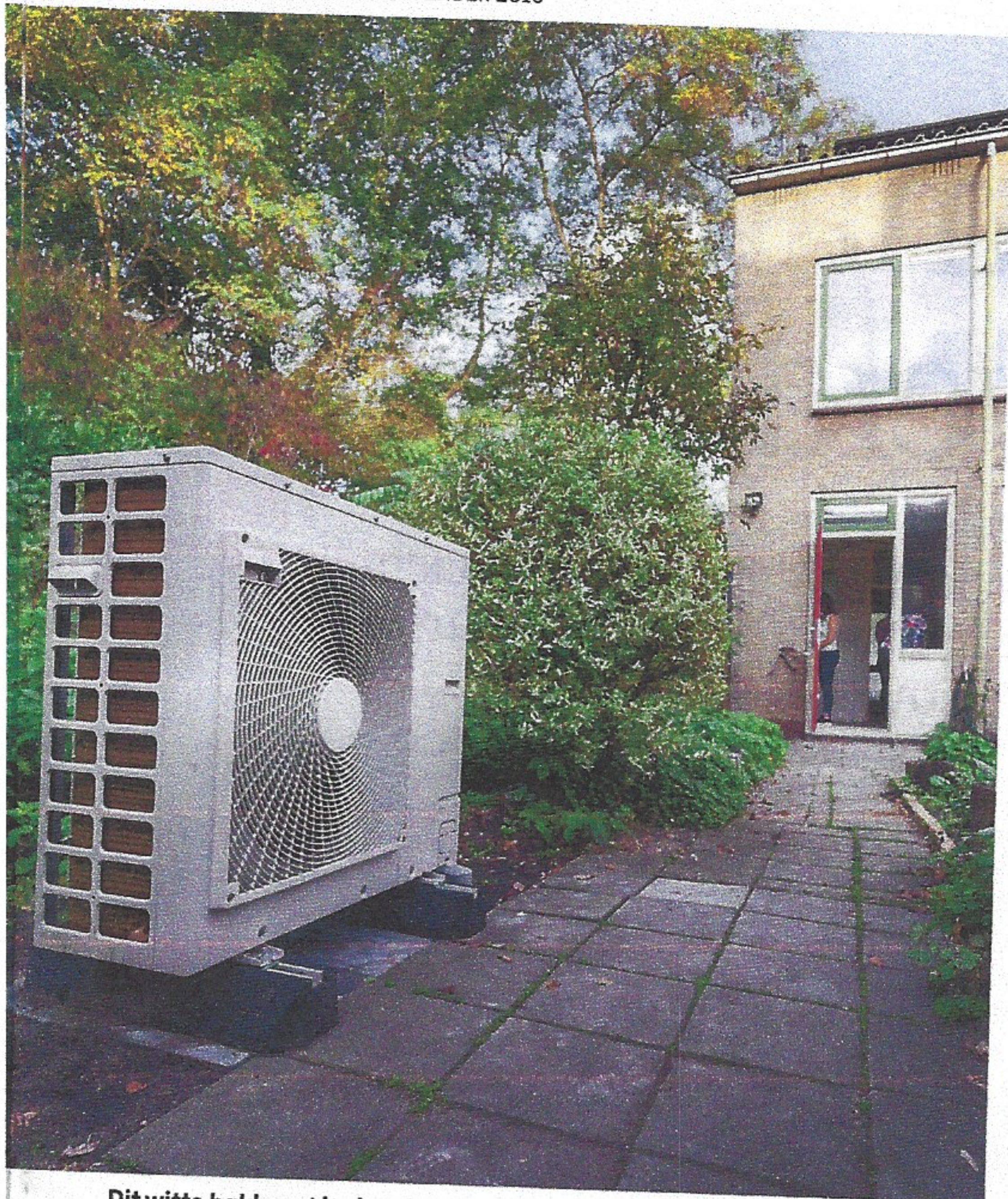
Dit witte bakbeest in de tuin is de ventilator van de warmtepomp op zolder
